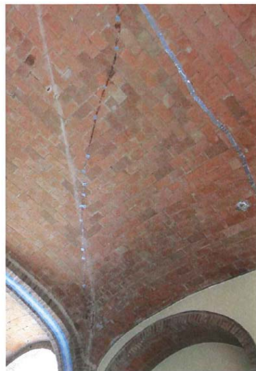
Foto 1. Fibra óptica en la bóveda.
